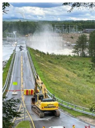
BRASKEREIDFOSS: Demningen i Braskereidfoss i Våler der en demning kan bli sprengt som følge av at vannet ikke kommer seg forbi slusene. Foto: Bård Langvandsli / NTB
