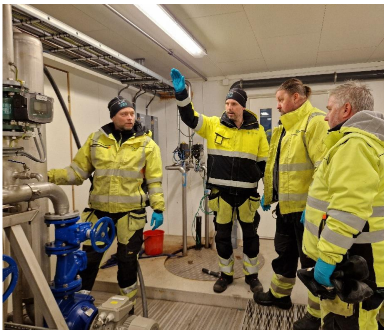
Bildet: Opplæring for teknisk vakt på Engerdal renseanlegg. Foto: Runa E. Skyrud
